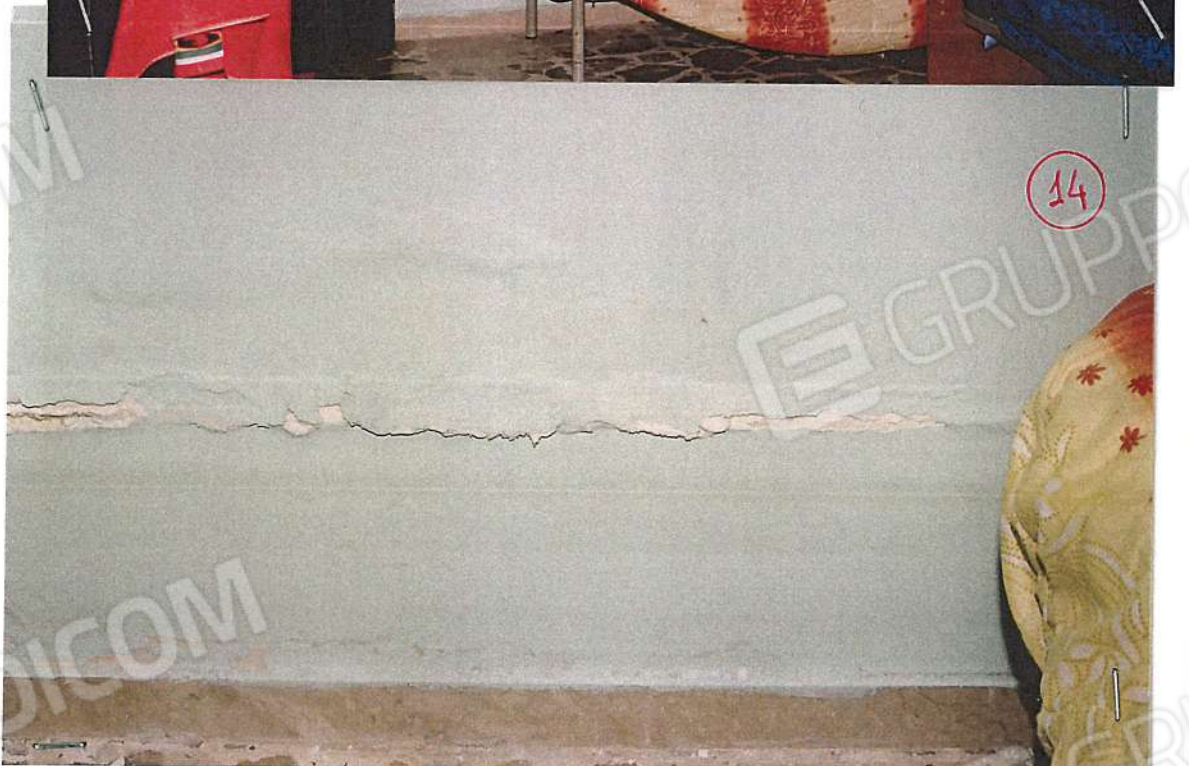
DANNI DA UMIDITA'
