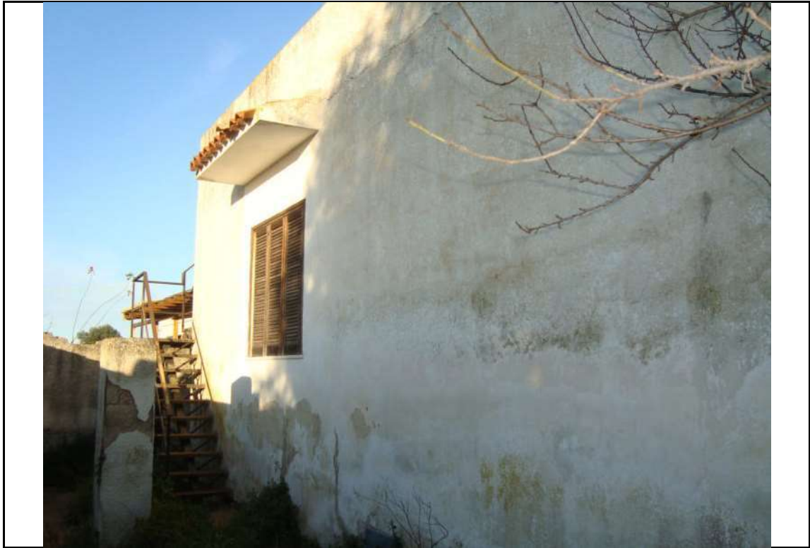
Foto n° 26. – Facciata – via per Canicattini n.18
