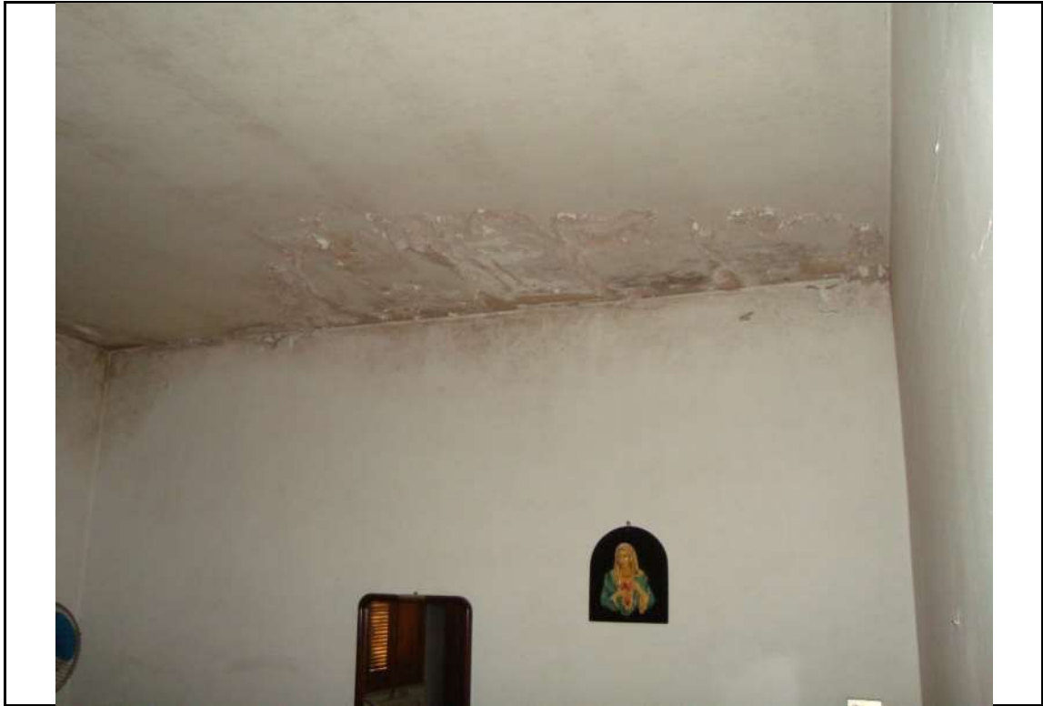
Foto n° 42. – Particolare infiltrazioni da copertura – via per Canicattini n.18
