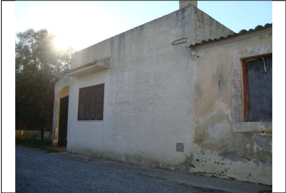
Foto n° 24. – Facciata – via per Canicattini n.18
