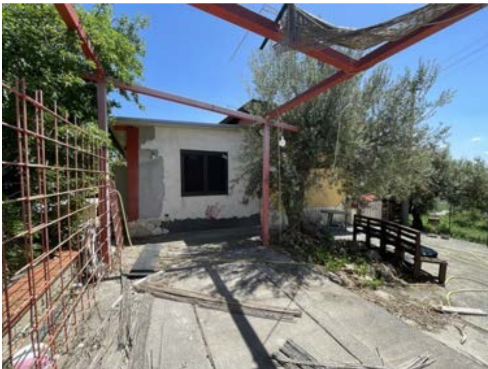
Fotografia D.12 - Prospetto nord-ovest-Struttura precaria prospiciente il fabbricato, (Gazebo)
