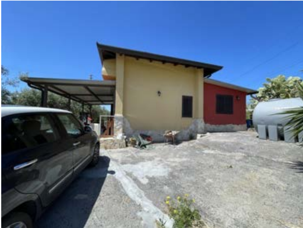
Fotografia D.7 - Prospetto sud-est: locale colore giallo regolare-locale rosso abusivo. Veranda regolare
