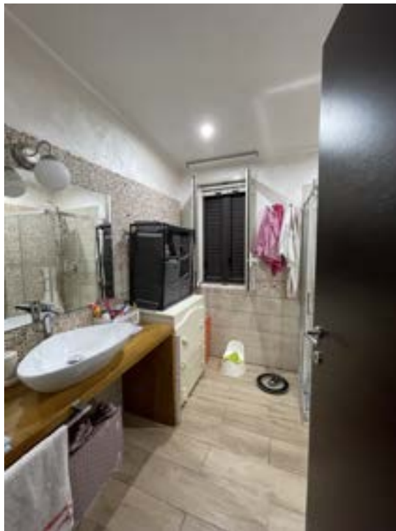
Fotografia D.22 - Piano Terra: bagno-locale abusivo
