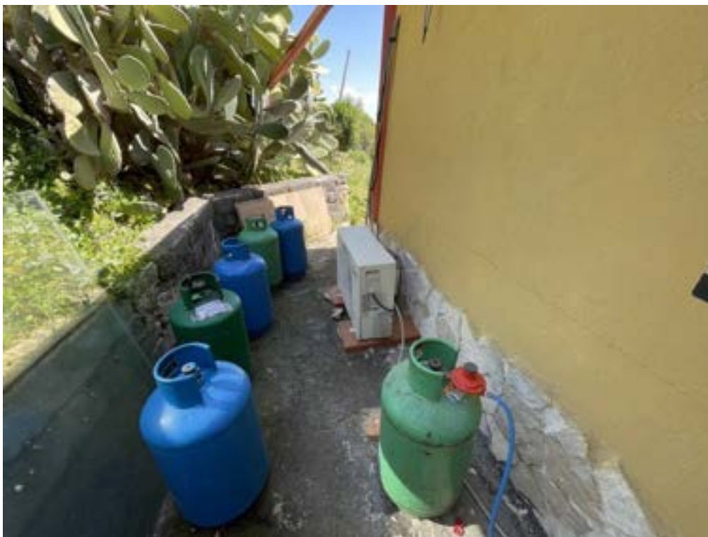
Fotografia D.16 - Parete nord-est: pompa di calore
