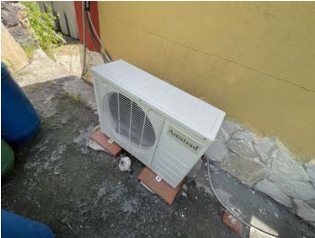
Fotografia D.17 - Parete nord-est: pompa di calore
