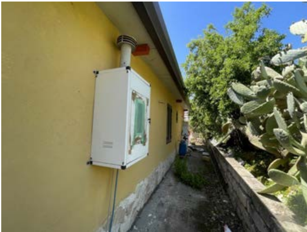
Fotografia D.14 - Parete nord-est: caldaia a gas per il riscaldamento acqua sanitaria
