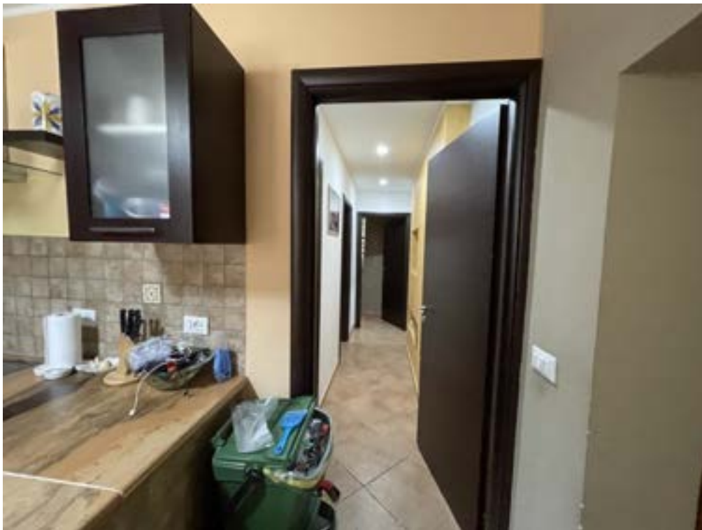
Fotografia D.20 - Piano terra: corridoio-locale abusivo
