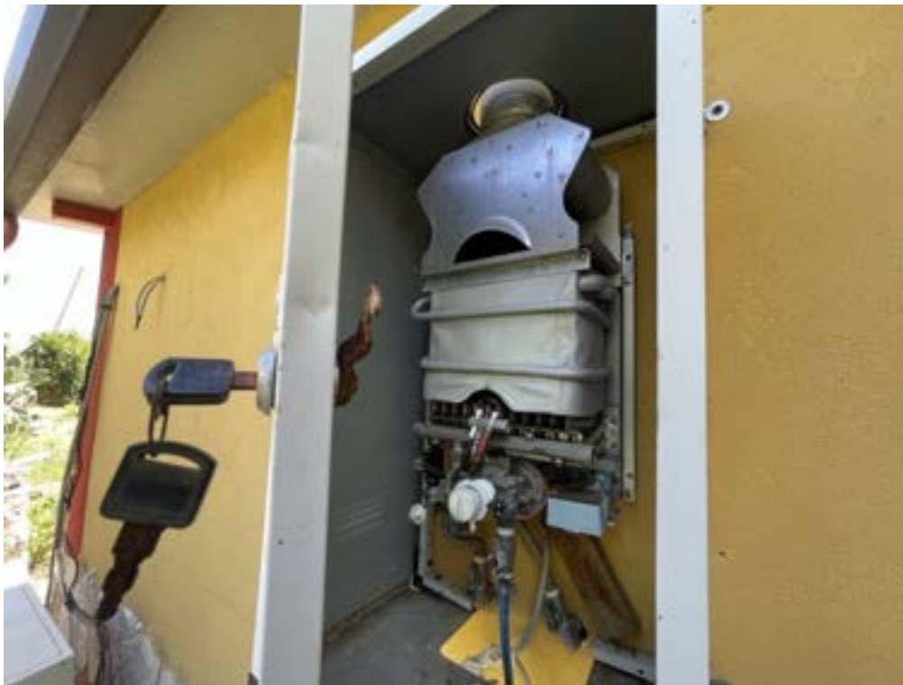
Fotografia D.15 - Parete nord-est: caldaia a gas per il riscaldamento acqua sanitaria
