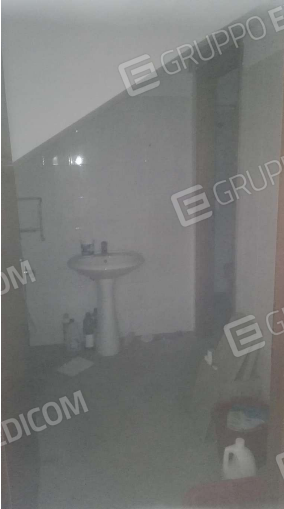
Foto 7 – vano antibagno e bagno
