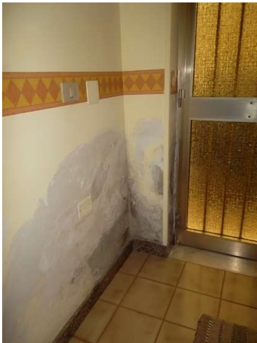
Foto 15 – Immobile “1A” – Umidità nell’ingresso a piano terra
