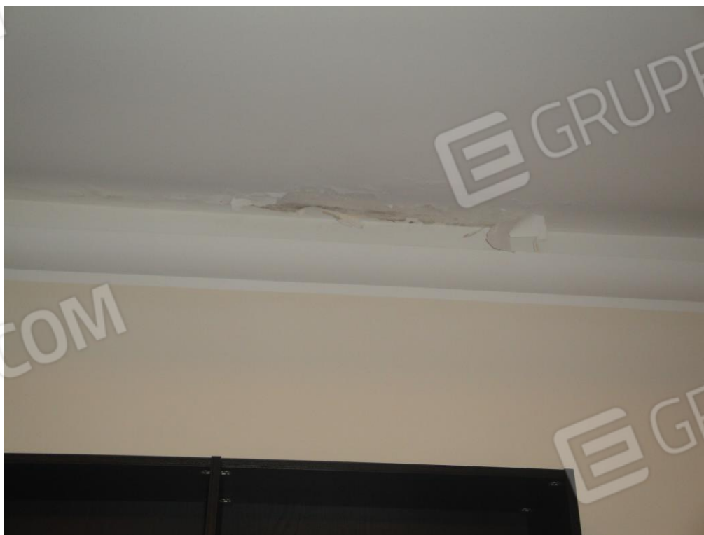
Foto 14_particolare di distacco di intonaco in corrispondenza del soffitto in soggiorno
