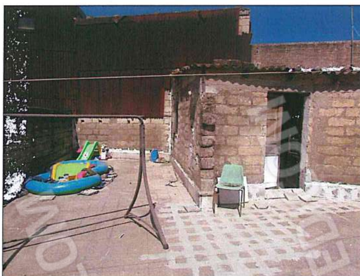
foto 21 - L'ambiente dante sulla terrazza non è rifinito in facciata, è coperto con struttura in legno ed eternit e non si trova in buono stato conservativo.
