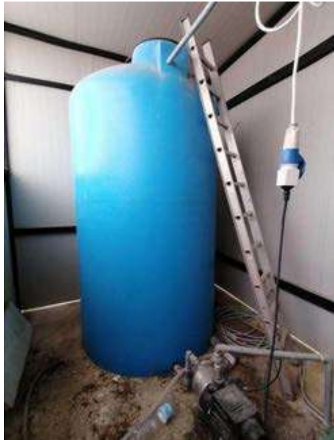
Foto 26 – Serbatoio di accumulo acqua
