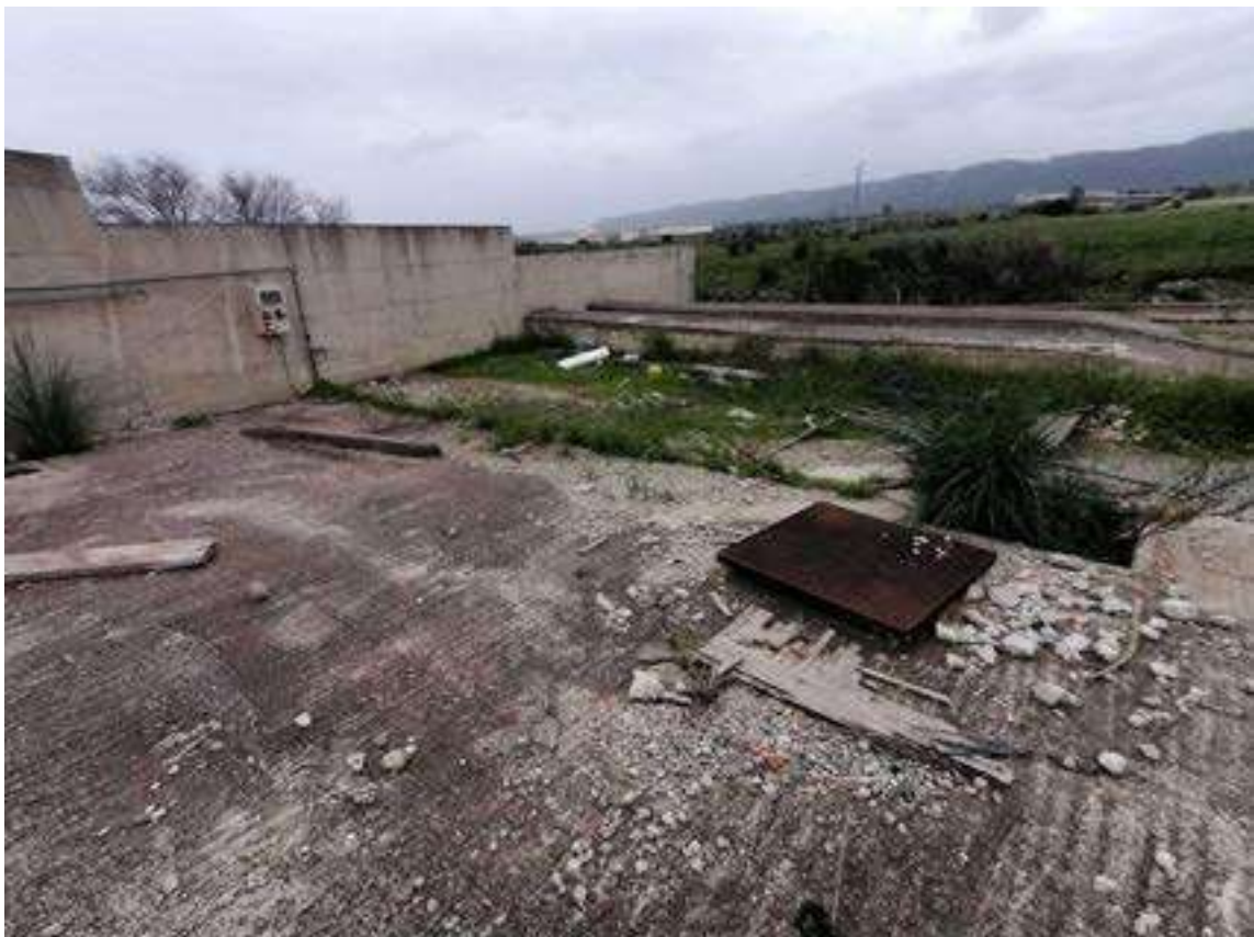
Foto 24 Zona sud area d'insediamento (pozzo trivellato)
