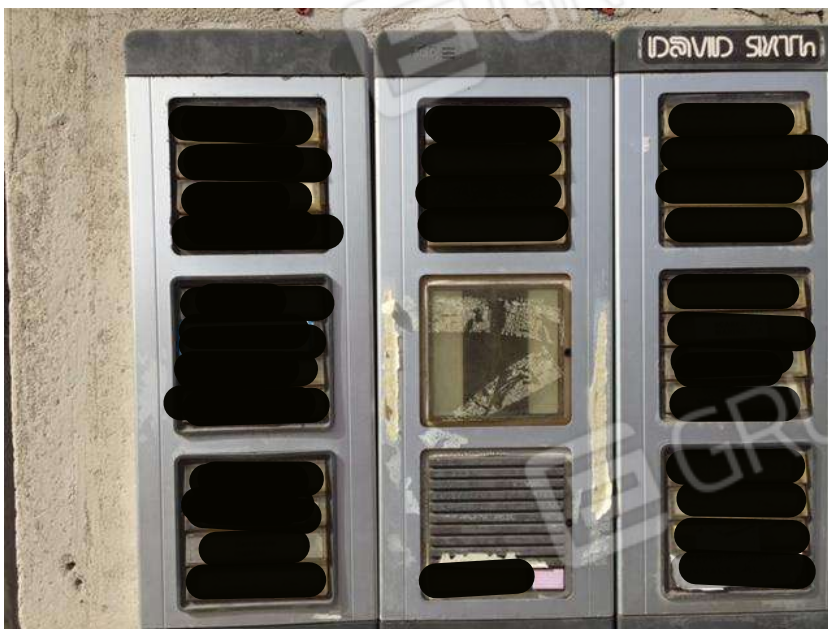
Foto 5. Citofono del complesso residenziale.
