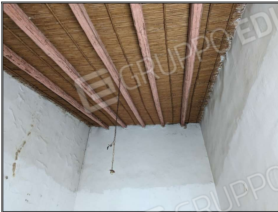
Foto n° 4 – Particolare soffitto vano 1
