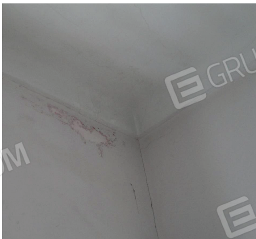
foto 14_ particolare del degrado sulle pareti e soffitto
