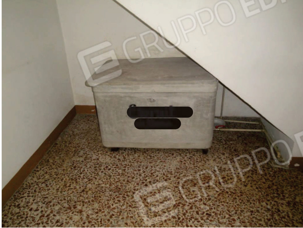
foto 7_ serbatoio in amianto-eternit nel piano sottopalcato
