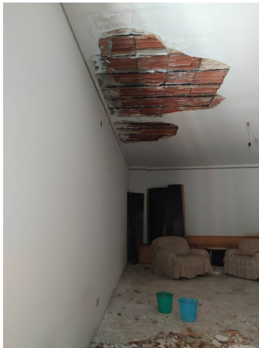
Sfondellamento del solaio del salone
