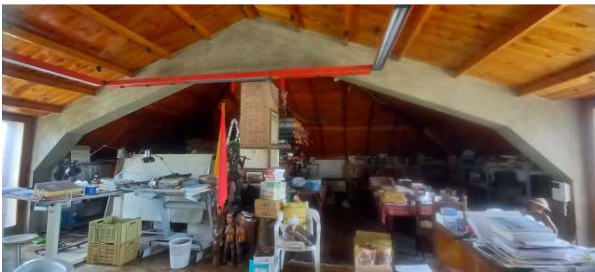
Foto 32 – Immobile “1A” – Locale sottotetto al I P
