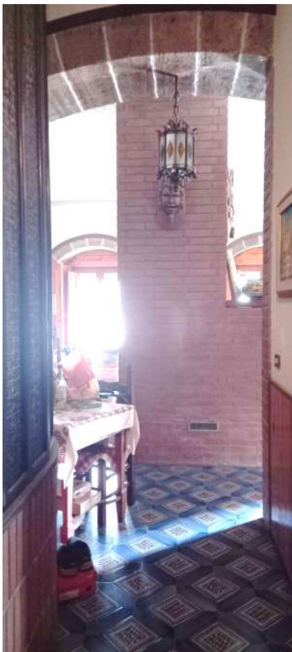
Foto 26 – Immobile “1A” – Disimpegno
