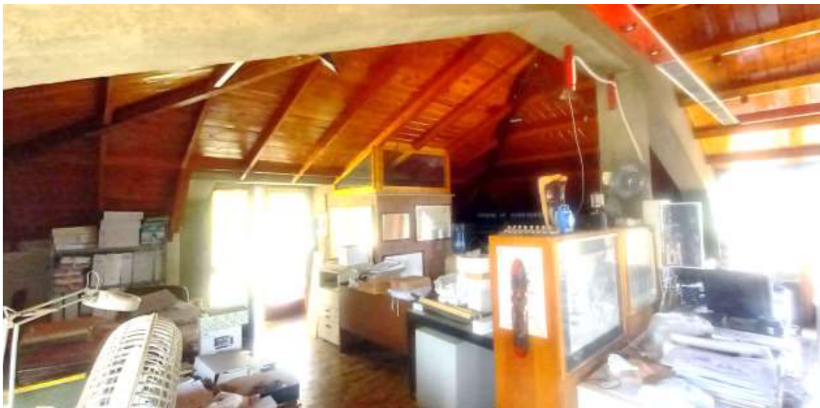
Foto 31 – Immobile “1A” – Locale sottotetto al I P
