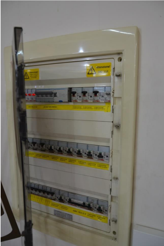
Fot. 19: piano primo, quadro generale impianto elettrico
