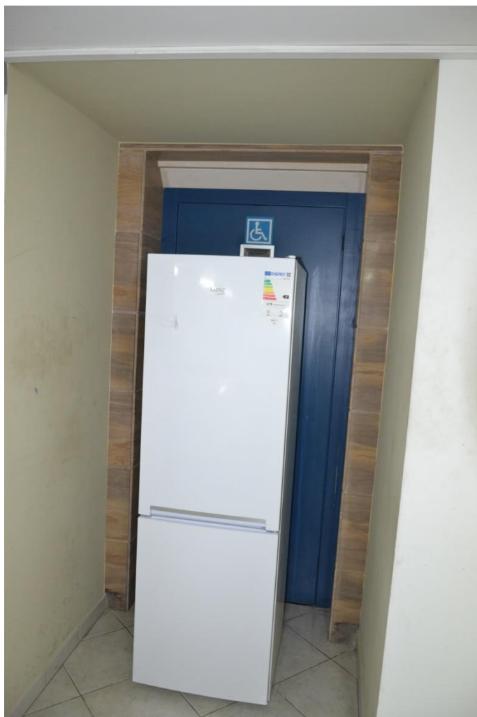
Fot. 6: piano interrato, ascensore
