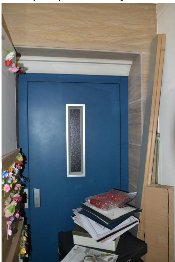
Fot. 18: piano primo, ascensore
