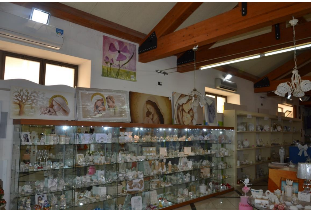
Fot. 20: piano primo, particolare sugli impianti di riscaldamento/raffrescamento (pompe di calore).
