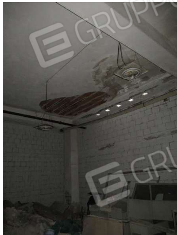
Foto 13_ Caduta intonaco su solaio
