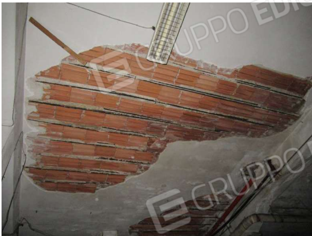
Foto 9_ Caduta intonaco su solaio
