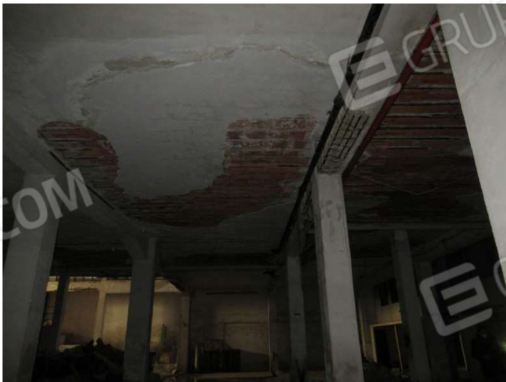
Foto 10_ Caduta intonaco su solaio
