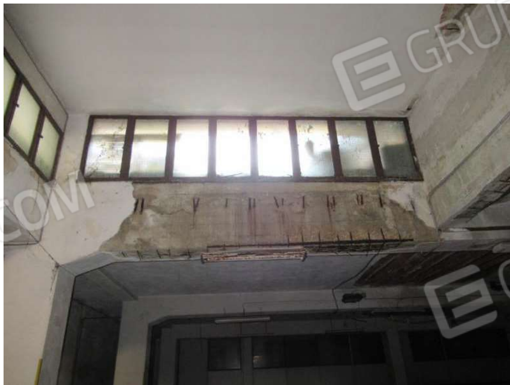
Foto 3_ Caduta intonaco copriferro su trave
