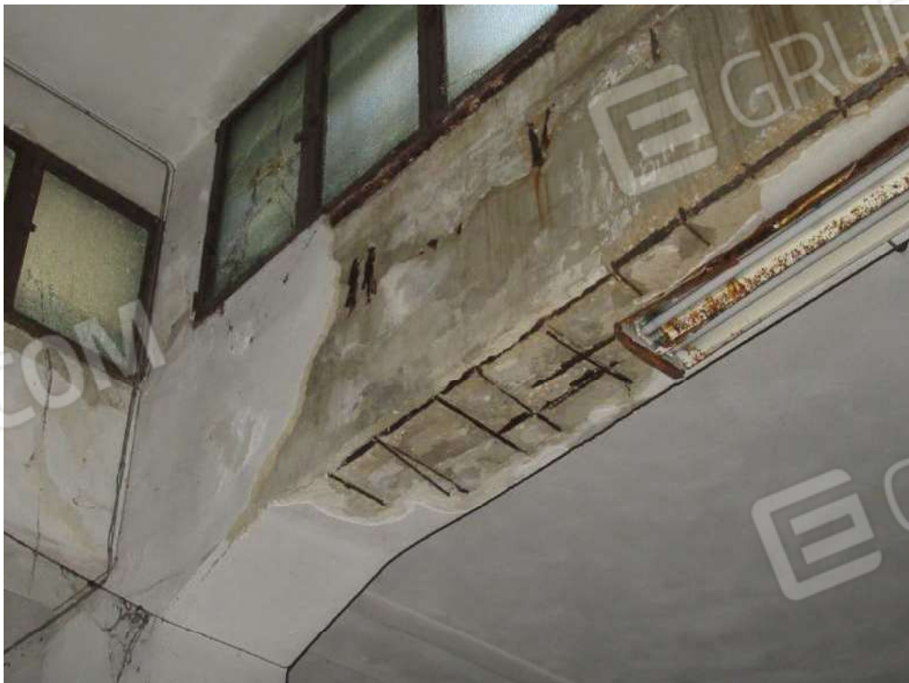
Foto 5_ Particolare caduta intonaco copriferro su trave
