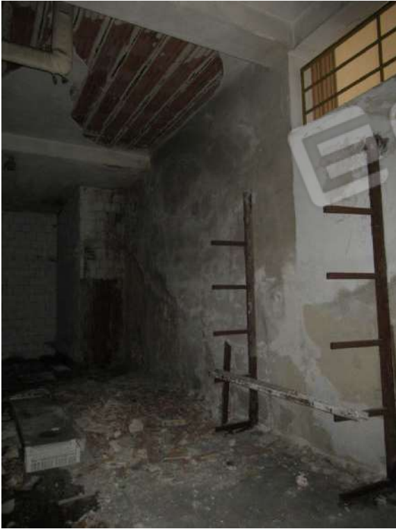
Foto 18_ Caduta intonaco su solaio e tracce di umidità alla parete
