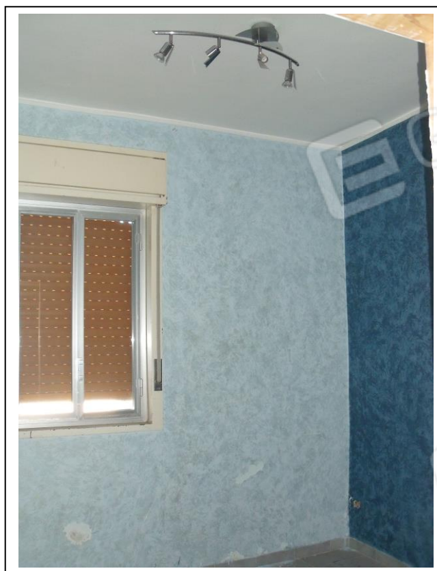
18. Interno u. i. con vista verso lato nord-ovest. Parziale distacco di intonaco in piccole porzioni di parete. Infisso vetusto.
