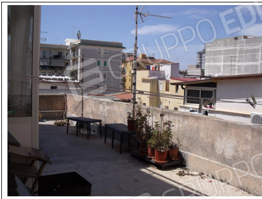
09. Terrazzo comune al piano 2, pavimentazione e parapetto in scarse condizioni di manutenzione.
