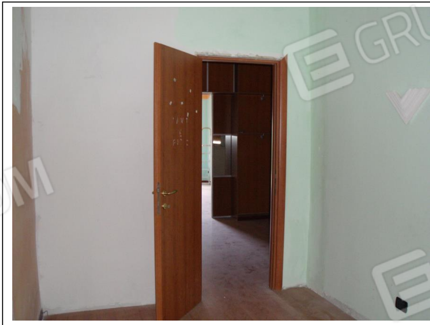
16. Interno u. i. con vista verso lato sud. Presenza di porta di accesso al vano in scarse condizioni di manutenzione.
