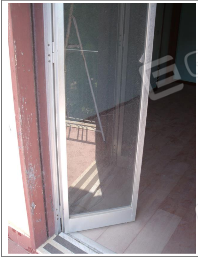
31. Esterno all'u. i. con vista verso lato nord-ovest, presenza di infisso vetusto di accesso al balcone.
