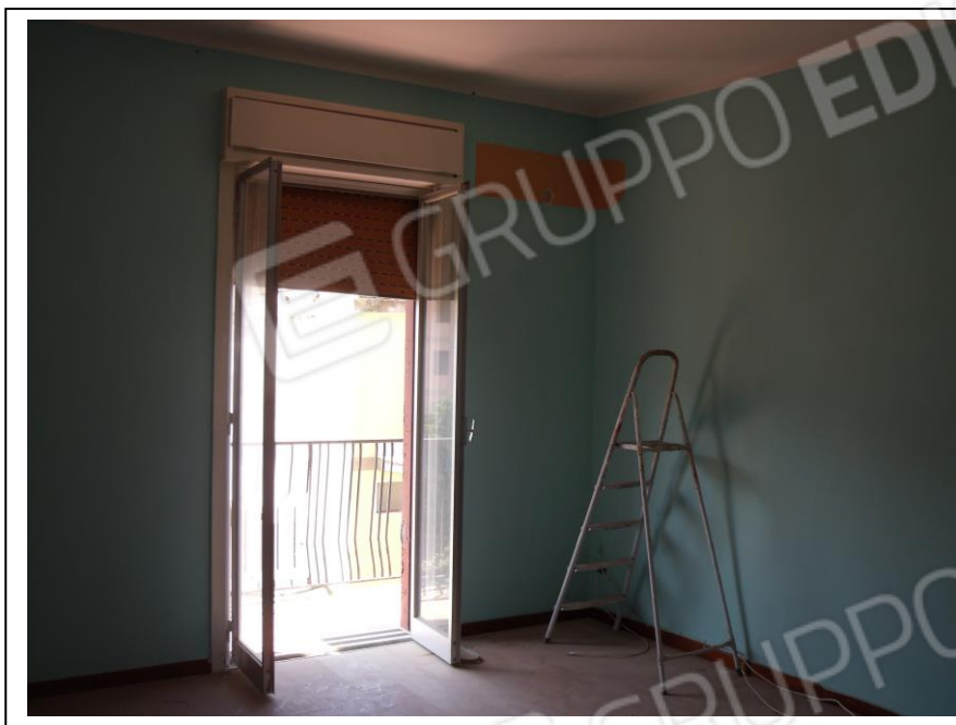
26. Interno u. i. con vista verso lato sud-ovest. Presenza di infisso vetusto di accesso al balcone in aggetto su lato strada.
