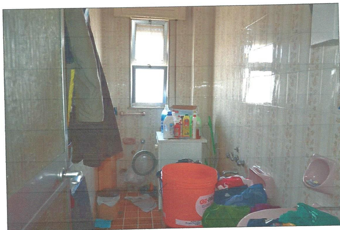
Fot.n°12: piano secondo, bagno ricavato su parte dell'immobile abusivamente ampliato.
