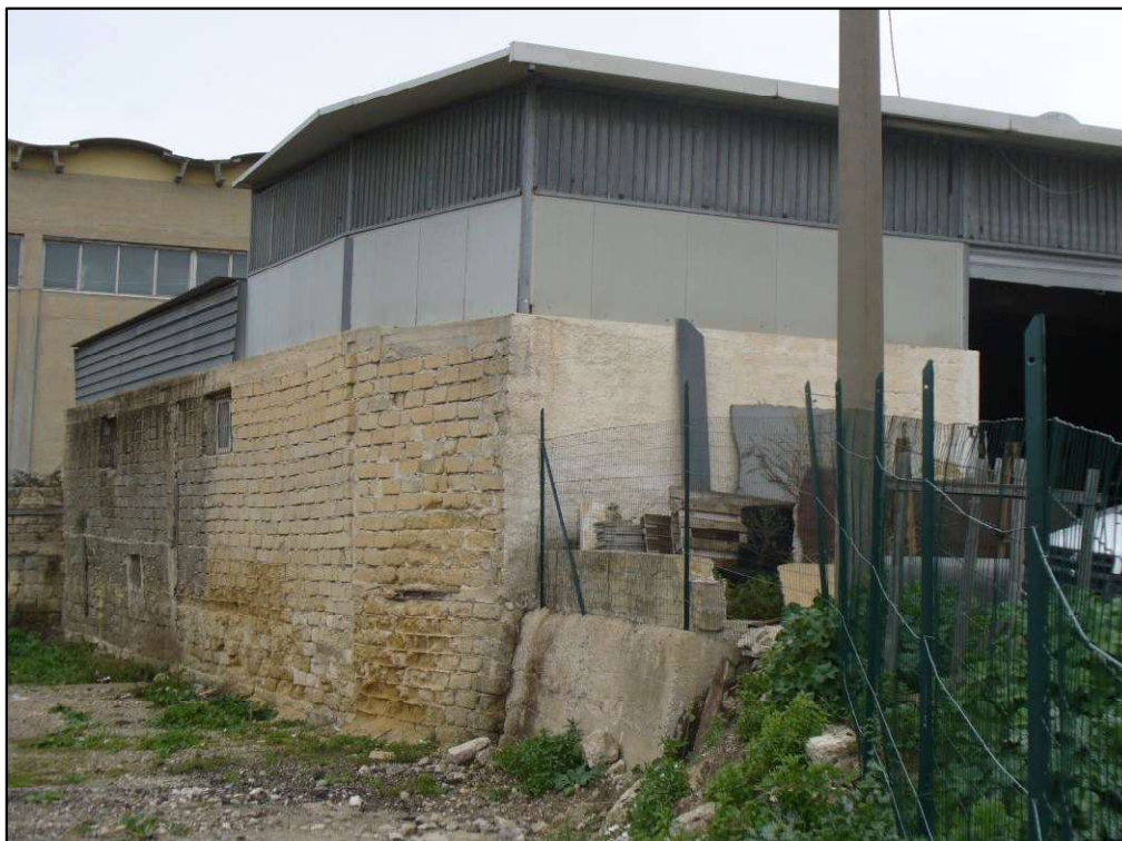
Foto 1 _Prospetto sud dell'immobile_Ripresa dell'01.12.2017 (prima del crollo)
