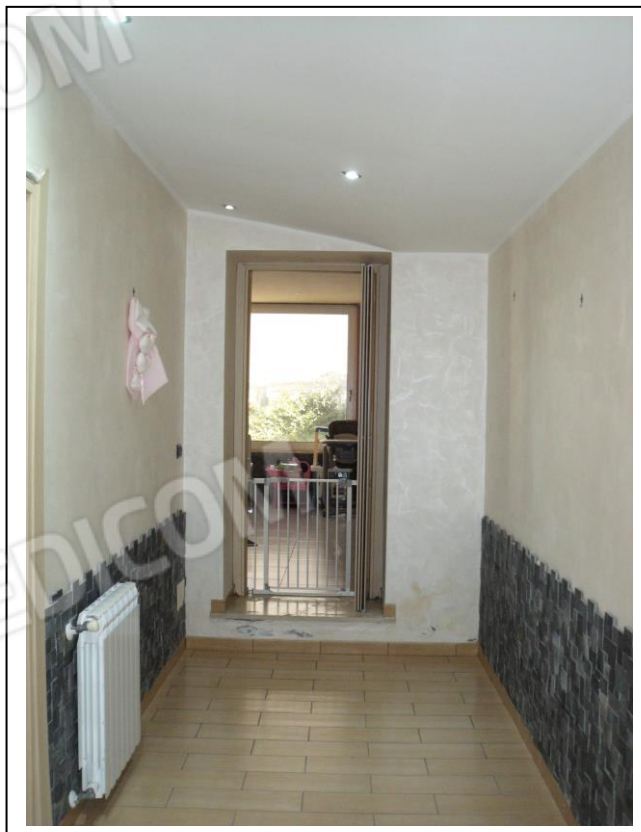
23. Interno dell'unità immobiliare (corridoio) con vista lato nord-est. In foto porta di accesso alla veranda coperta chiusa.
