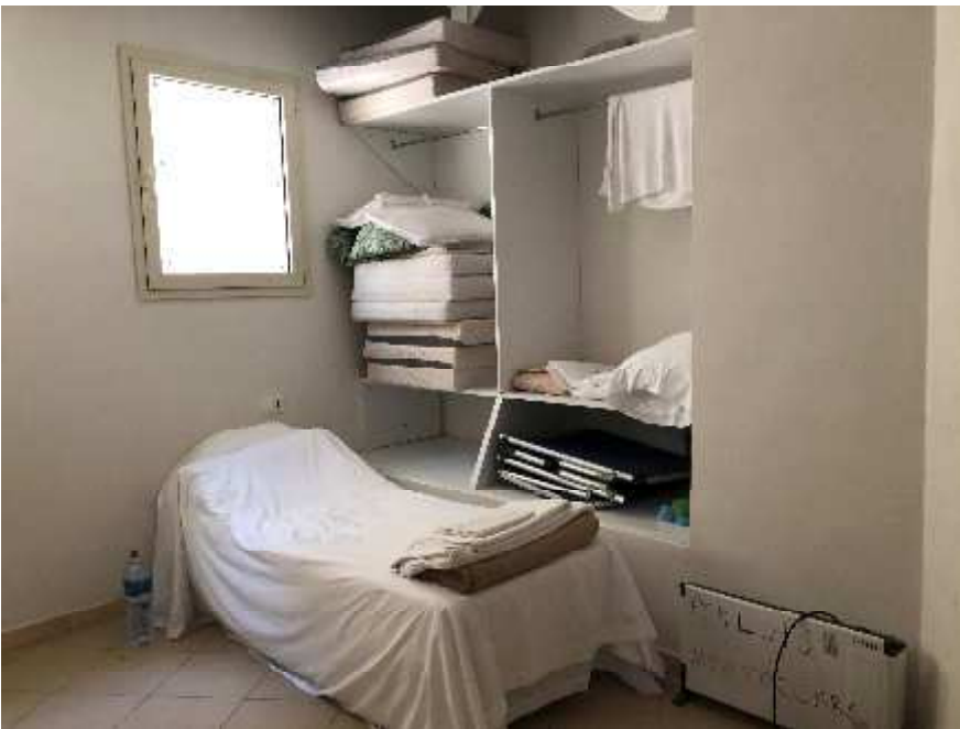
Foto 48: Vista piano cantinato con destinazione d'uso variata e da ripristinare
