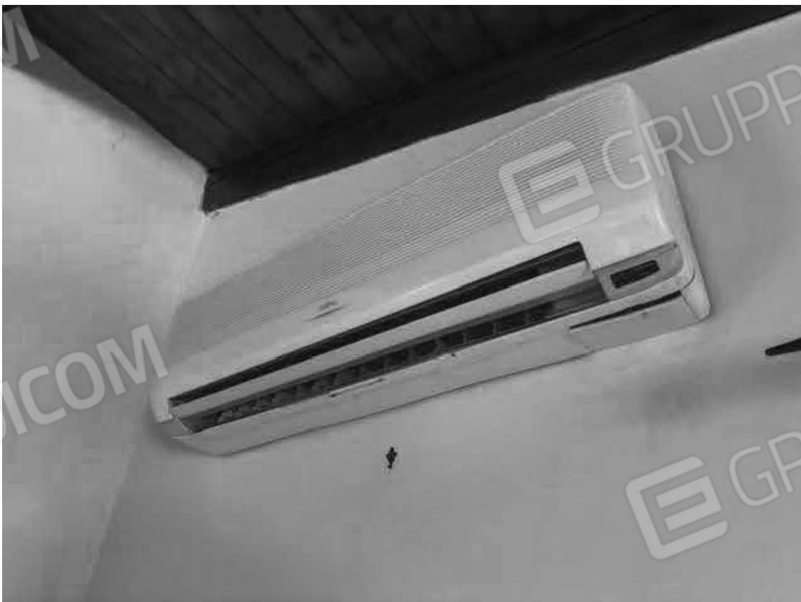
20 – Impianti – Climatizzatore su soggiorno
