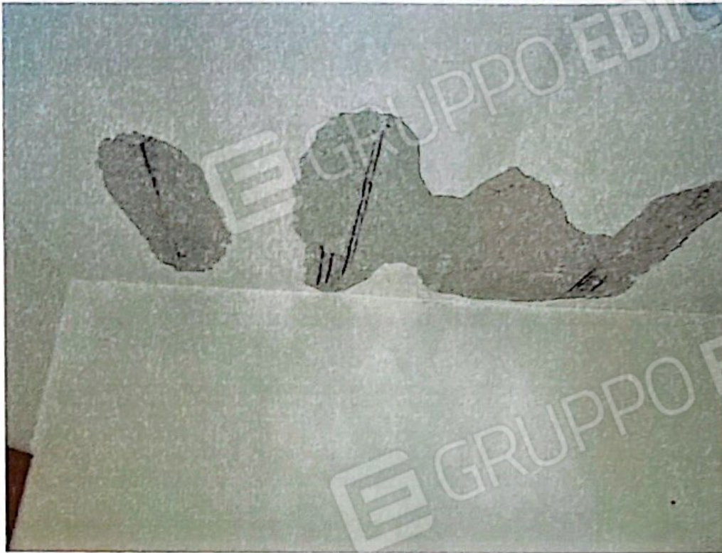
Foto 11: Vista dei danni presenti al soffitto dell'ambiente posto al terzo piano
