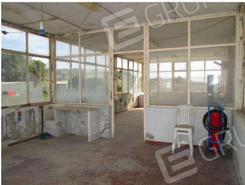
Foto 59. Locale Ingresso e pesatura.
