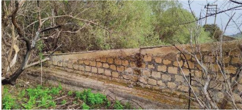
Foto 70 locale vasca plla 237
