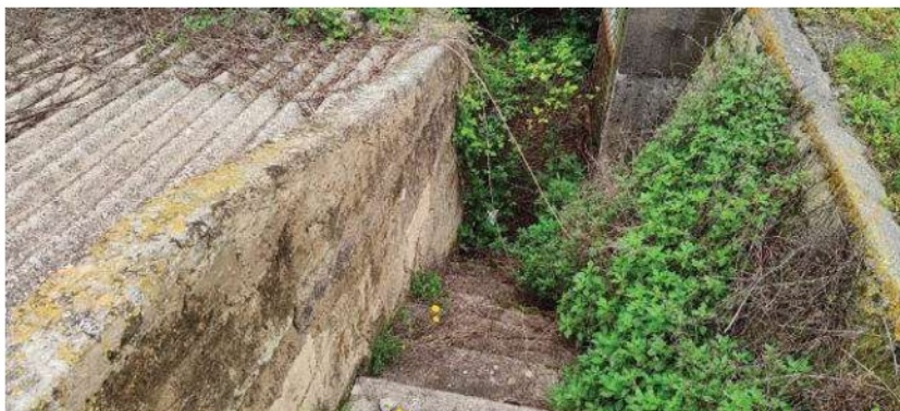
Foto 72 locale vasca plla 237
