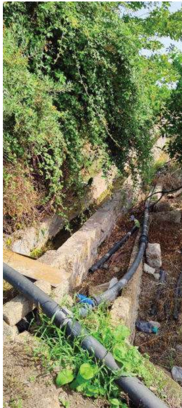
Figura 9 dettaglio impianto di irrigazione su p.lle 171-172 e 173
