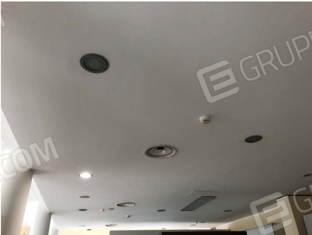
Foto n° 10 – Controsoffitto piano terra
