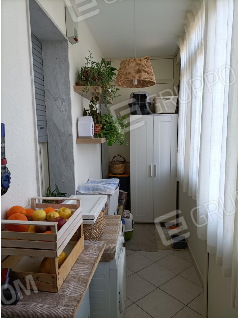
Foto 13. Vista del balcone a nord-est chiuso con struttura precaria in alluminio e vetro.
