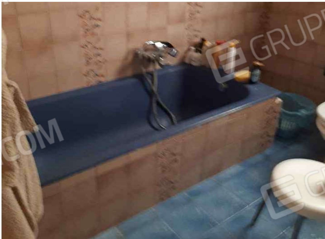
G.15 – altra veduta del bagno (vani 7) con affaccio sul pozzo luce interno.
