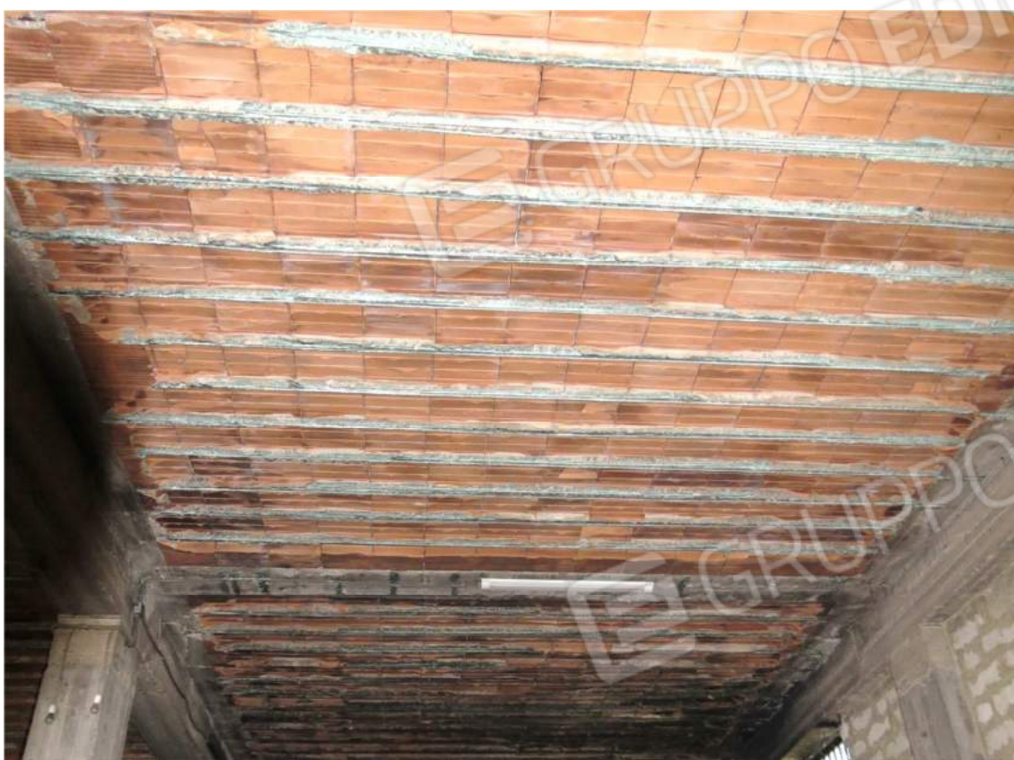
Foto n. 15: Bene A.2 – Particolare del fenomeno di sfondellamento diffuso su tutto il solaio
