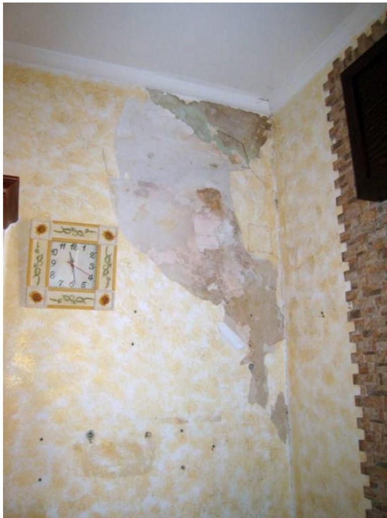
Foto n. 17. La macchia di umido presente all'interno della cucina-soggiorno e precisamente sulla parete Sud.
