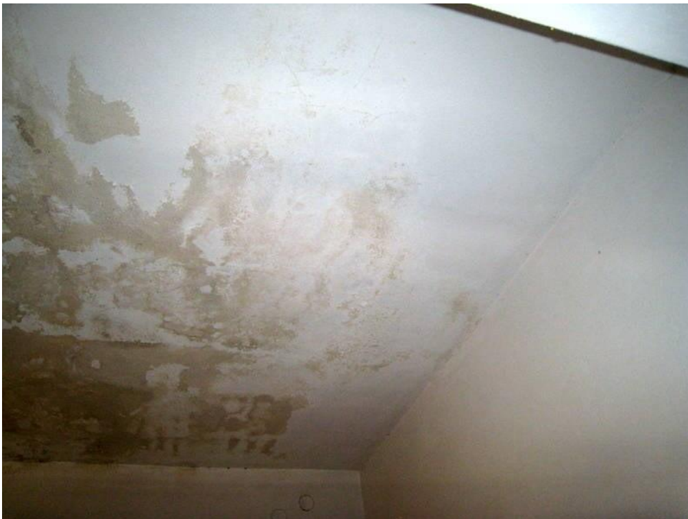
Foto n. 21. Il tetto della lavanderia è in cattive condizioni.
