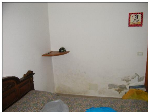
Foto 38. Tracce di umidità di risalita nella camera
