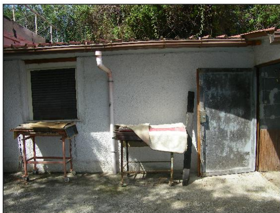
Foto 26. Magazzini edificati senza autorizzazione
