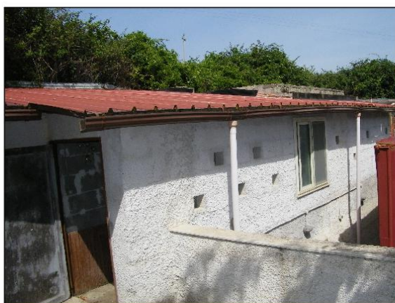
Foto 28. Magazzini edificati senza autorizzazione
