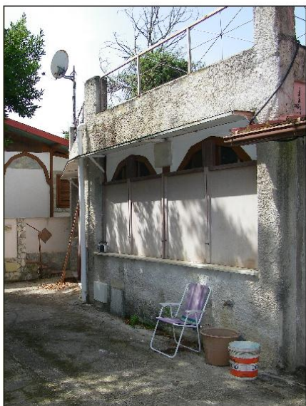
Foto 21. Tettoia tompagnata abusivamente
