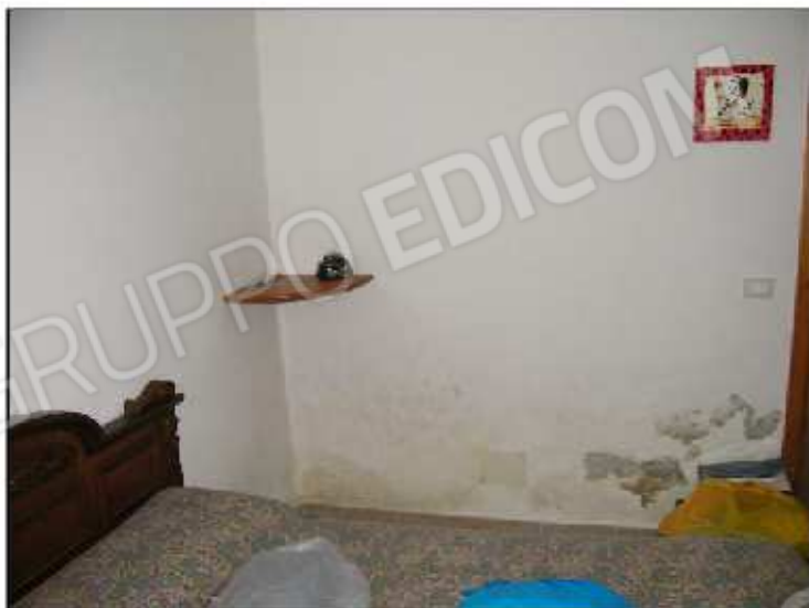
Foto 38. Tracce di umidità di risalita nella camera
