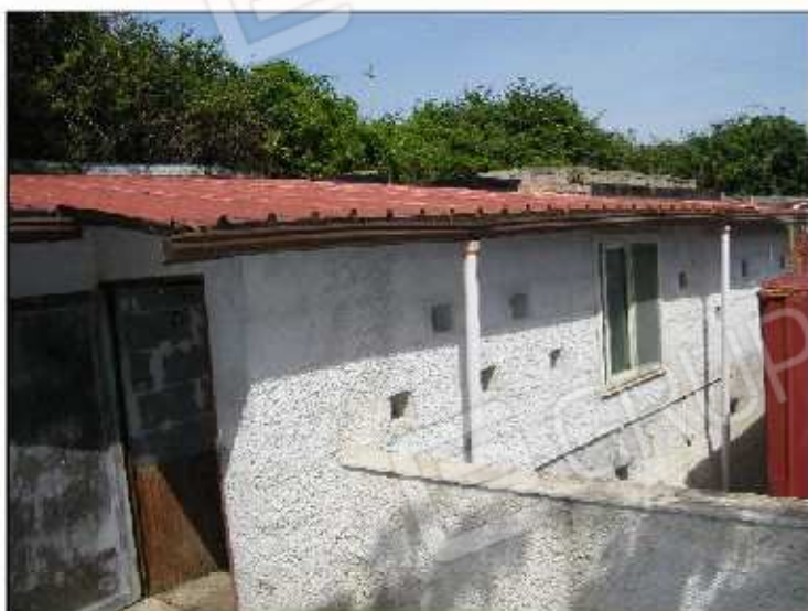
Foto 28. Magazzini edificati senza autorizzazione
