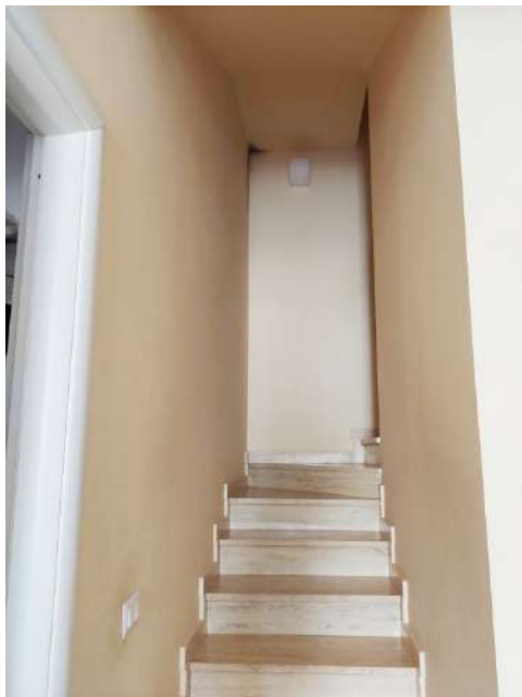
Foto 18 – Scala interna abusiva
