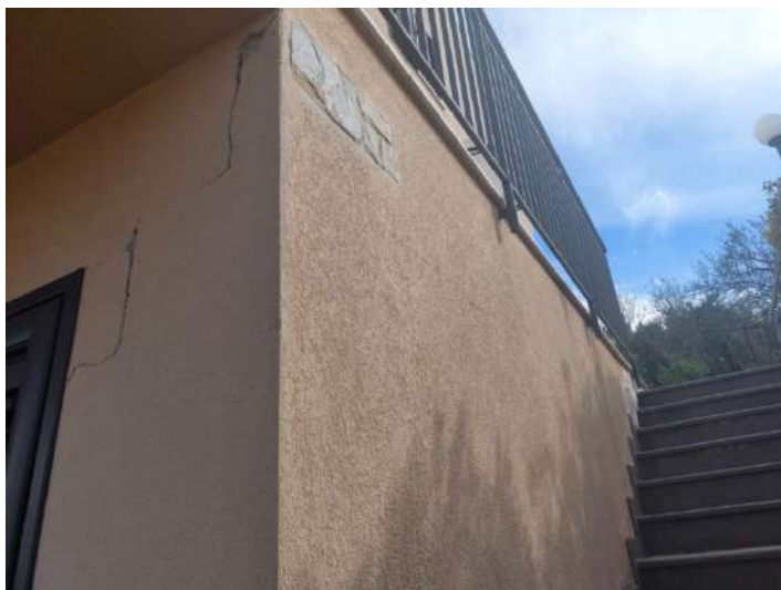
Foto 37 – Particolare della porzione di intonaco lesionato
