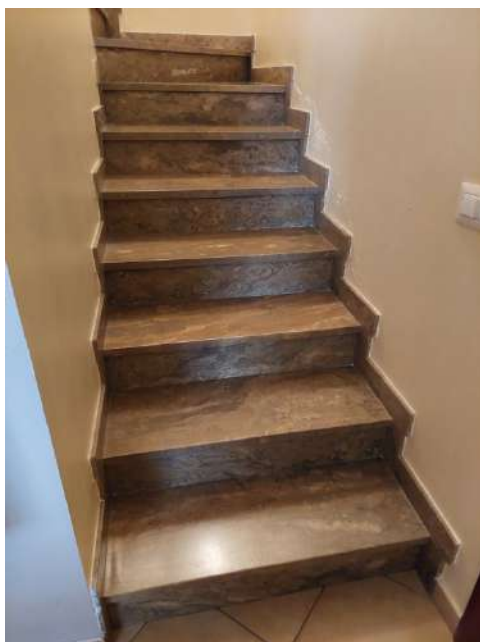
Foto 18 – Scala interna abusiva
