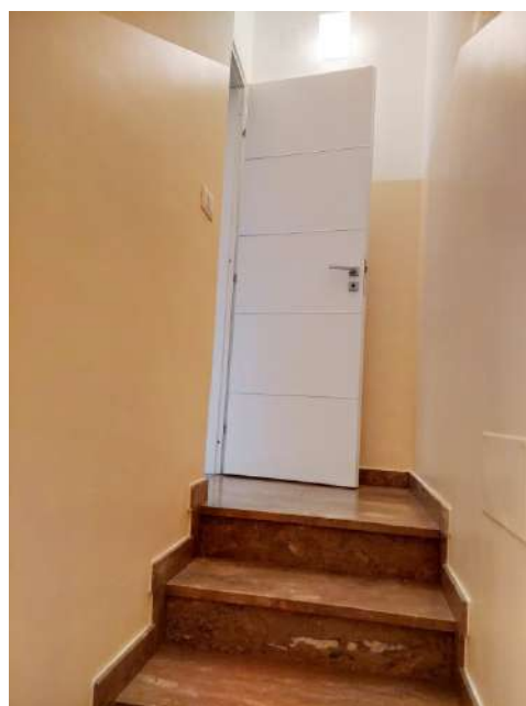
Foto 19 - Scala interna abusiva
