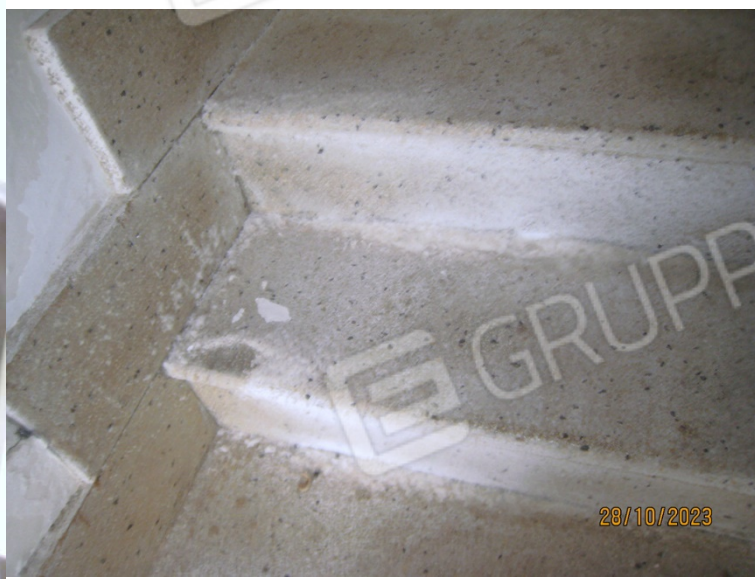
Foto n. 14. Dettaglio dell'umidità di risalita anche nella scala.
