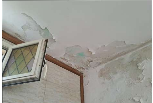
piano terzo - soffitto - tracce di umidità
