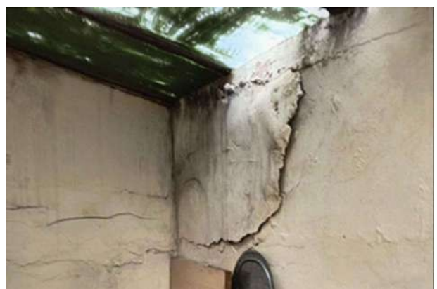
piano terzo - zona soppalco - tracce di umidità
