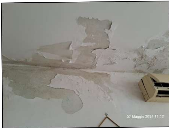
piano terzo - soffitto - tracce di umidità
