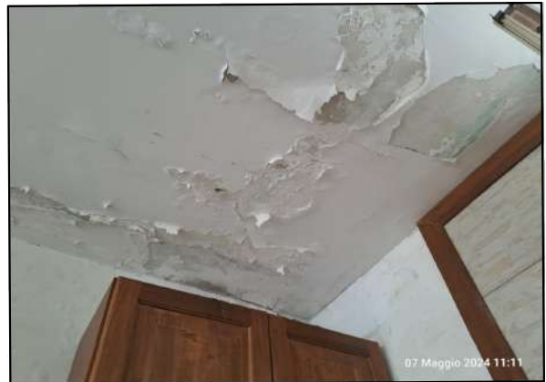
piano terzo - soffitto - tracce di umidità
