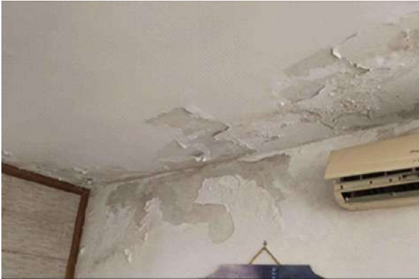
piano terzo - soffitto - tracce di umidità
