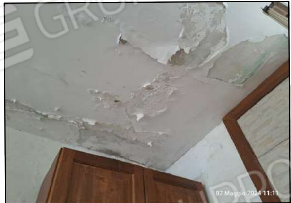
piano terzo - soffitto - tracce di umidità
