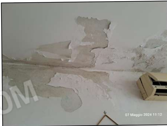
piano terzo - soffitto - tracce di umidità
