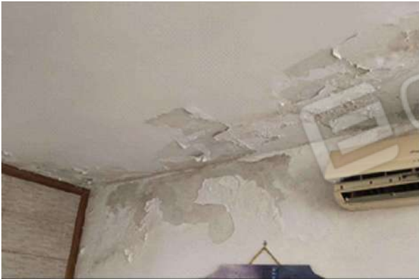
piano terzo - soffitto - tracce di umidità
