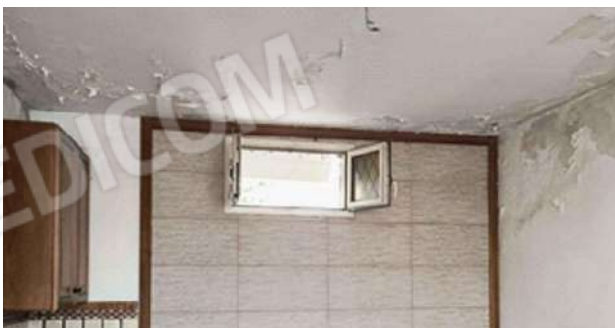
piano terzo - soffitto - tracce di umidità
