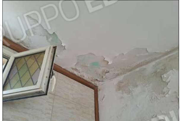
piano terzo - soffitto - tracce di umidità
