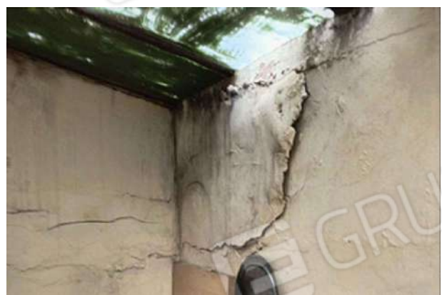
piano terzo - zona soppalco - tracce di umidità
