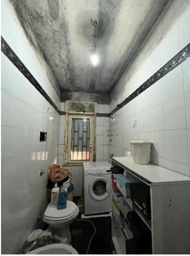
Foto 7- Muffa sul soffitto del wc
