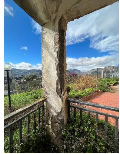
Foto 9- Ossidazione dei ferri di armatura
