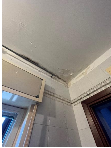
Foto 8- Sfogliatura del soffitto del wc
