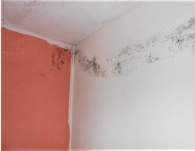
24. Piano 2°, la camera con macchie condensa
