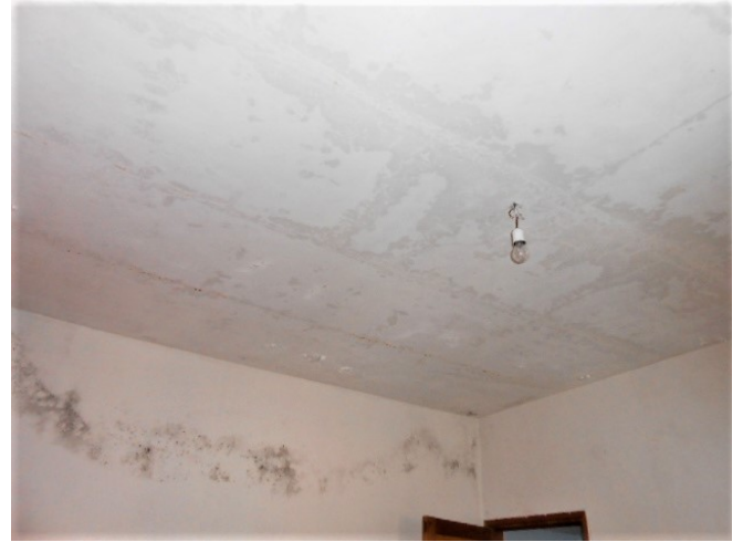
25. Piano 2°, la camera con macchie di condensa
