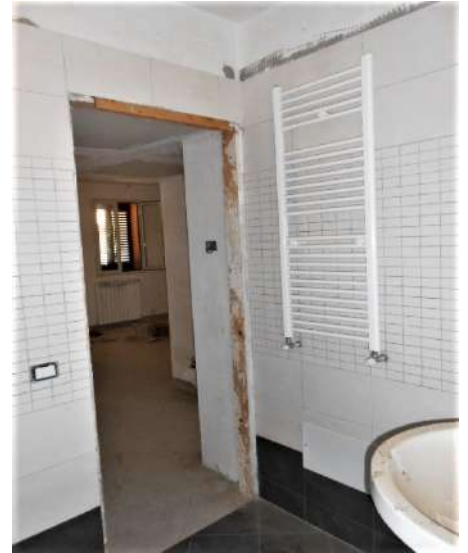
12. WC DOCCIA AL PIANO TERRA. MANCA LA PORTA INTERNA
