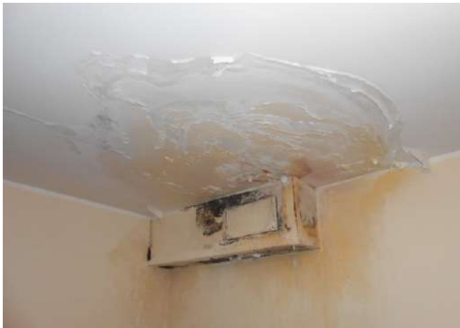
17. VASTE MACCHIE DI UMIDITÀ AL PIANO S1
