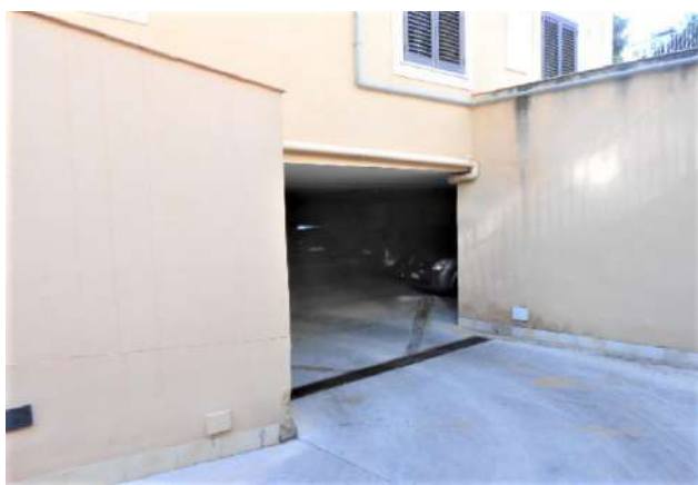
3. LA RAMPA CONDOMINIALE CHE CONDUCE DAL PIANO TERRA AL PARCHEGGIO COPERTO SOTTOSTRADA IL CUI VANO DI ACCESSO È PRIVO DI INFISSO
