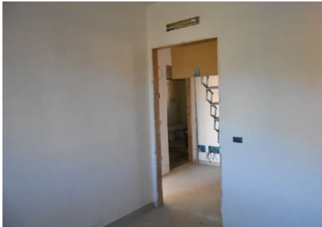
14. PIANO 1. SI NOTANO LA MANCANZA DELLE PORTE INTERNE E SI INTRADEVE LA SCALETTA RETRATTILE APERTA, PER L'ACCESSO AL SOTTOTETTO
