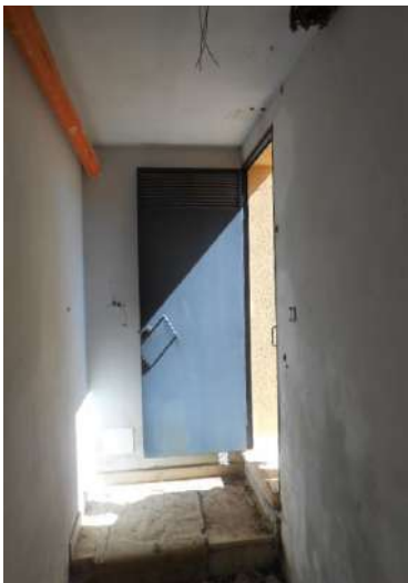
22. PIANO SOTTOSTRADA (S1). CORTE SUD . INTERNO LOCALE AUTOCLAVE E CISTERNA
