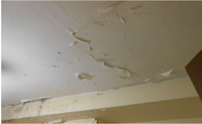
18. VASTE MACCHIE DI UMIDITÀ AL PIANO S1
