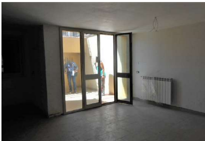
22. PIANO SOTTOSTRADA (S1). LA PORTAFINESTRA CHE IMMETTE NELLA CORTE SUD LATO VIA SANTA MARINA QUARTO
