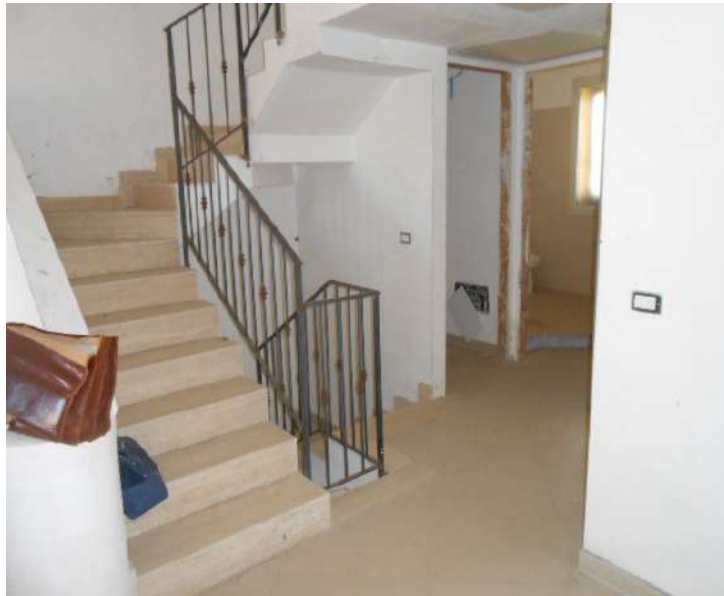
9. PIANO TERRA. INGRESSO-SALOTTO. MANCANO LE PORTE INTERNE IN TUTTI I PIANI
