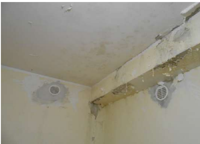
13. VASTE MACCHIE DI UMIDITÀ AL PIANO S1 DERIVANTI DA INFILTRAZIONI DALLE CORTI DEL PIANO TERRA
