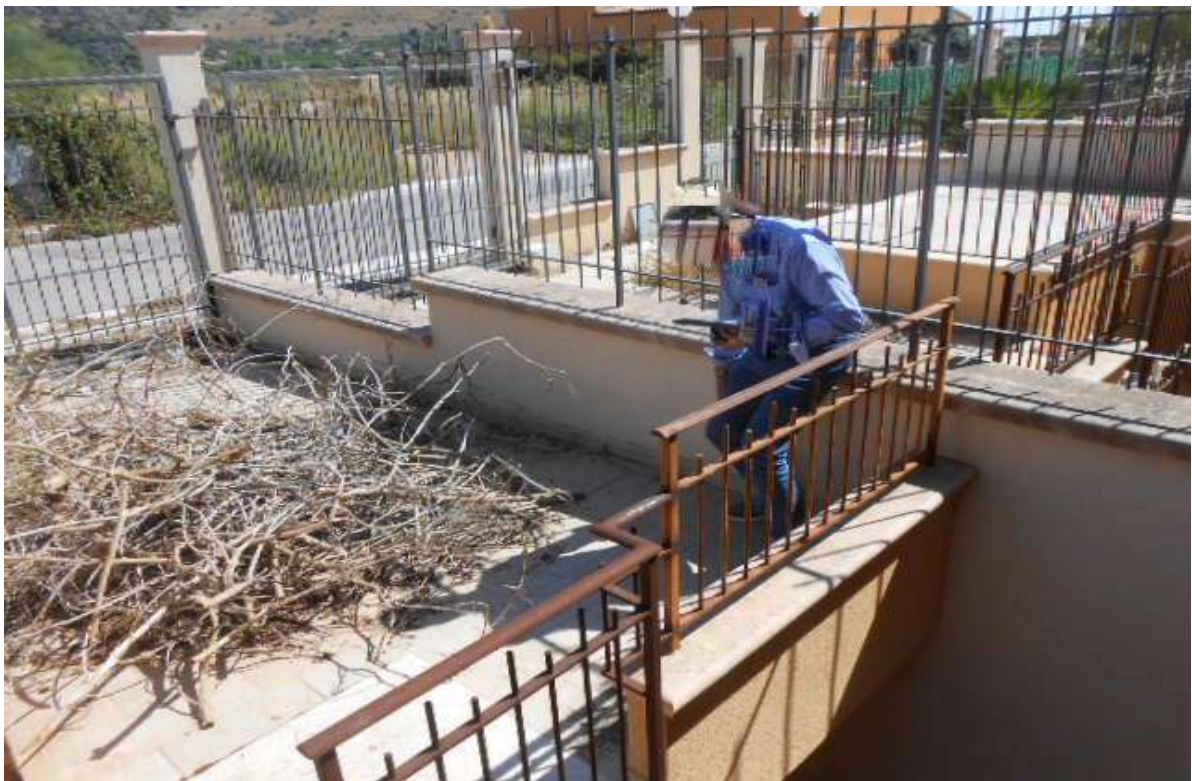
7. LE AIUOLE SONO IN UNO STATO DI ABBANDONO
