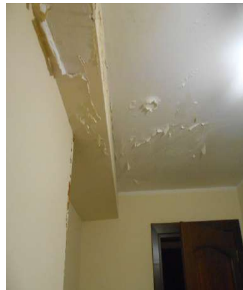
14. VASTE MACCHIE DI UMIDITÀ DERIVANTI DA INFILTRAZIONI
