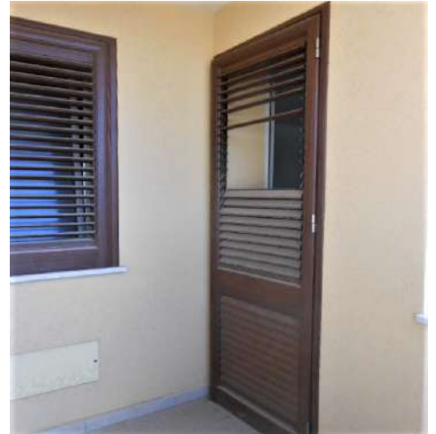
13. PIANO 1. L'INFISSO DELLA LOGGETTA È MANCANTE DI ALCUNE STECCHE INCLINATE (C.D. "GELOSIE") E OCCORRE RIPRISTINARLE.
