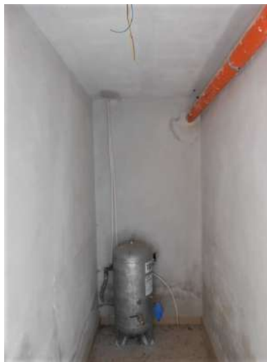
23. PIANO SOTTOSTRADA (S1). CORTE SUD . INTERNO LOCALE AUTOCLAVE E CISTERNA
