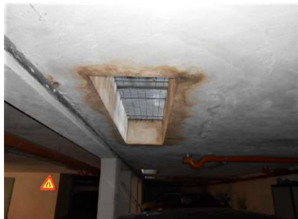
6. NEL PERIMETRO DEL LUCERNARIO NEL SOFFITTO DEL POSTO AUTO SI NOTANO MACCHIE DI UMIDITÀ PREGRESSA DA INFILTRAZIONI D'ACQUA DAL PIANO TERRA
