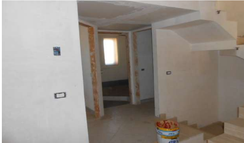
10. PIANO TERRA. MANCANO LE PORTE INTERNE E LA RINGHIERA NELLE RAMPE DELLA SCALA INTERNA
