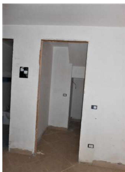
19. PIANO SOTTOSTRADA (S1). MANCANO TUTTE LE PORTE INTERNE
