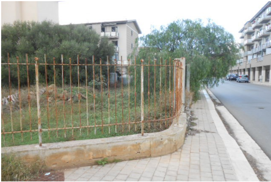
7. La recinzione del Lotto sulla via Santa Marina. Sono visibili i pilastri del cancello e l'adeguamento del marciapiede all'accesso carrabile.
