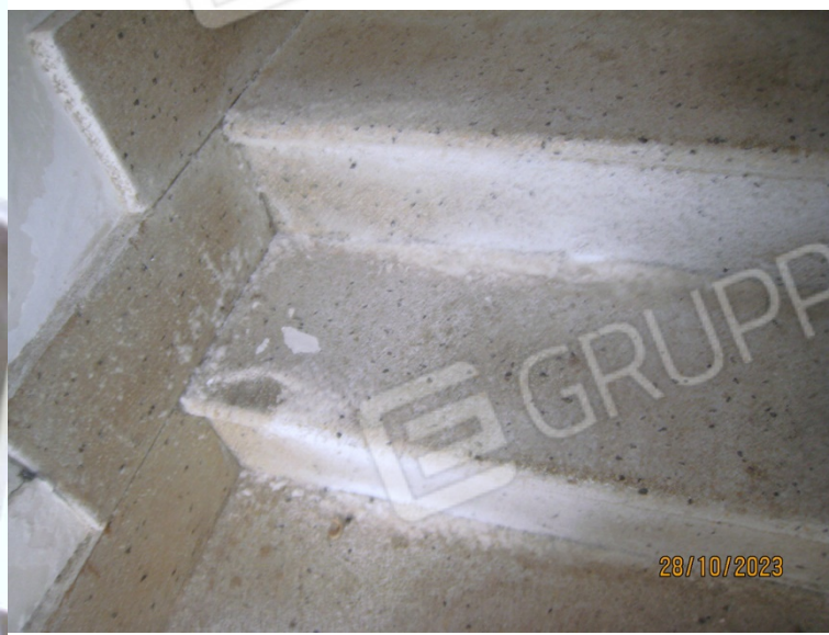
Foto n. 14. Dettaglio dell'umidità di risalita anche nella scala.
