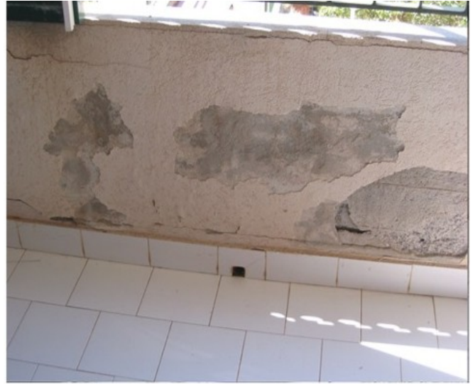
DETTAGLIO AMMALORAMENTO SUPERFICIE MURATURA INTERNA PARAPETTO
