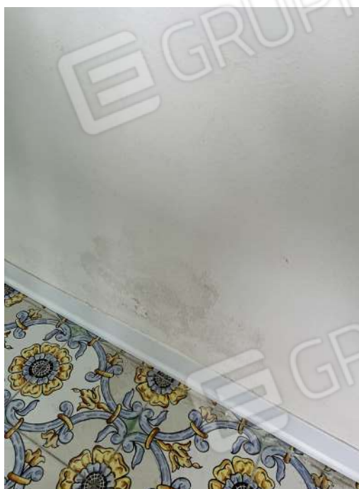
Foto 28 - Ammaloramenti su parte basamentale
