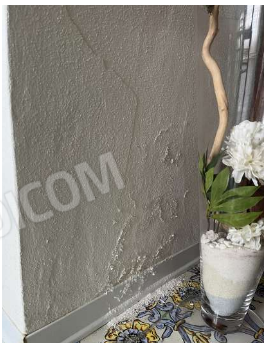
Foto 27 - Efflorescenze nella parte basamentale
