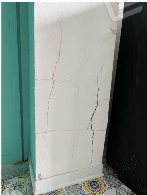
Foto 25 - Lesioni su pilastro
