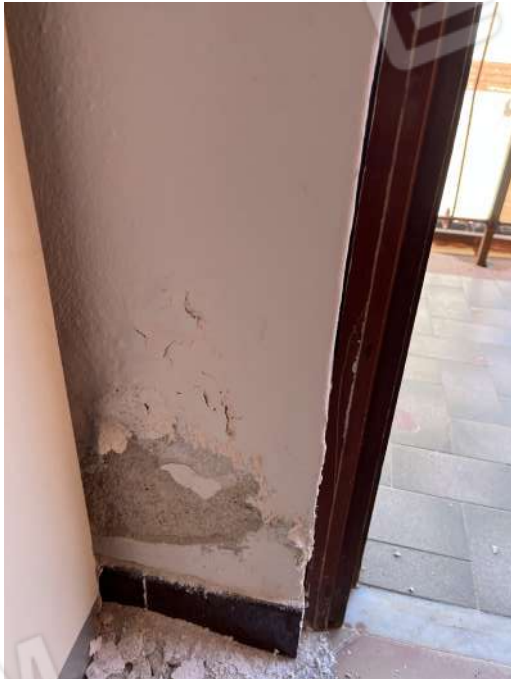
Foto 29 - Ammaloramenti su parte basamentale
