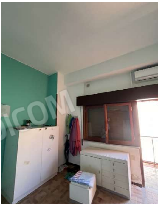
Foto 31 - Vano a dibito a Camera 2 (piano primo)
