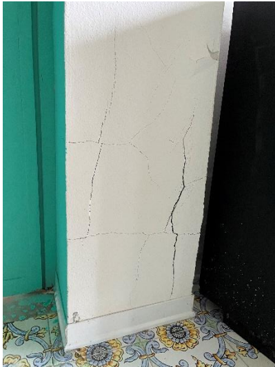
Foto 20 – Lesioni su pilastro
