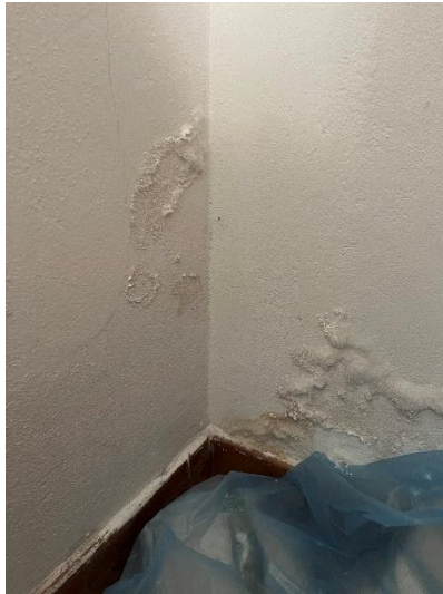
Foto 21- Umidità da risalita con presenza di efflorescenze saline
