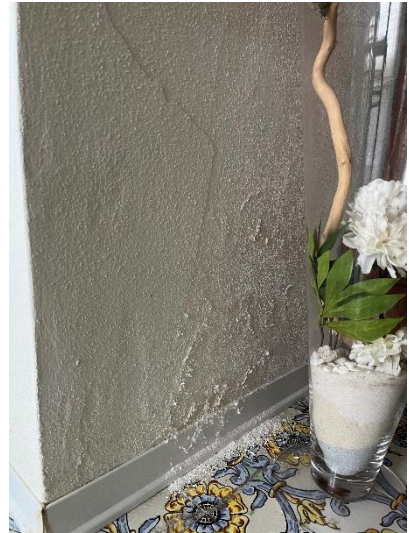
Foto 22- Efflorescenza saline nella parte basamentale della parete
