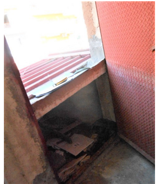
5. Il sottotetto determinatosi dalla copertura del lastrico solare ha un'altezza interna al colmo di 1,00 mt.
