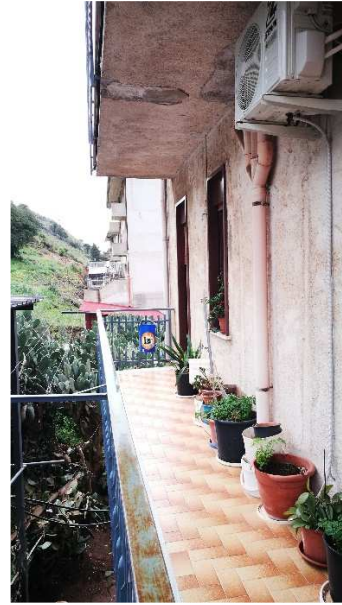
Intradosso balcone - segni di ammaloramento
