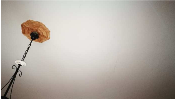
Soffitto cucina - primi segni di sfondellamento
