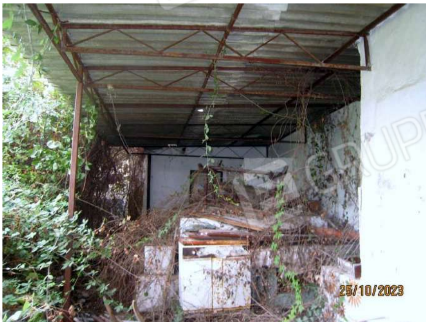
Foto n. 9-10. Manufatti abusivi sul retro.
