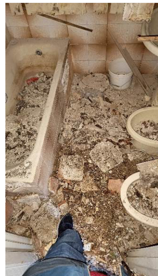
Distacchi di intonaco dal soffitto del w.c. 3 piano terra
