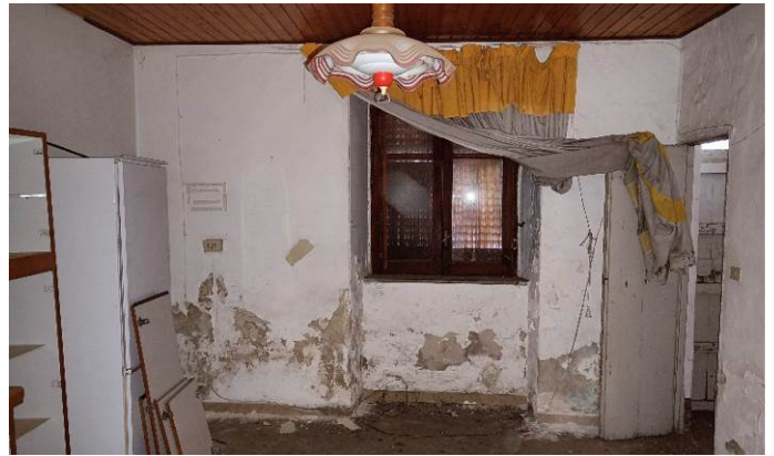
Umidità di risalita soggiorno 4 piano terra
