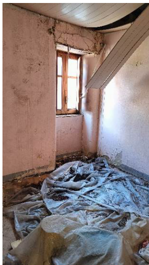
Controsoffitto crollato camera 3 secondo piano
