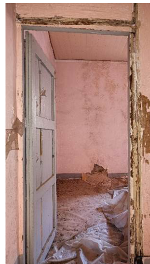
Lesioni nella muratura portante camera 3 secondo piano
