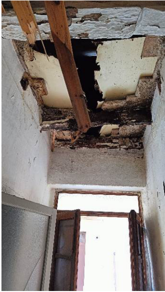
Travi e solaio ammalorate zona ingresso 1 piano terra
