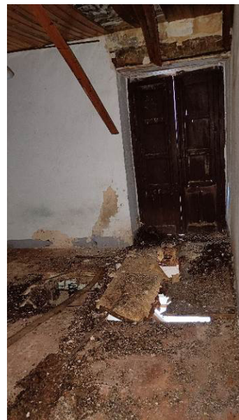
Solaio di interpiano crollato camera 3 primo piano
