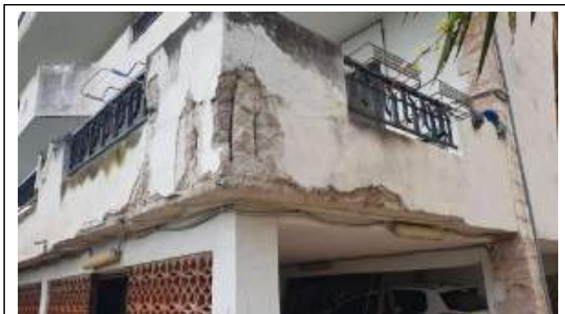
Foto n. 6. Scrostamento del balcone dell'alloggio pignorato.
