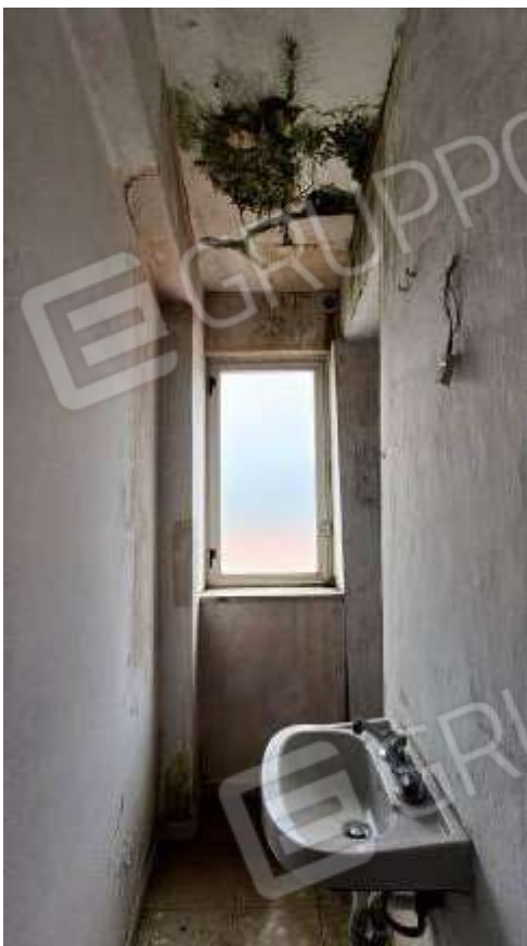
FOTO 9 – WC (4), particolare del soffitto ammalorato
